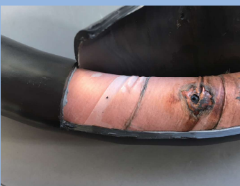
人工地絡試験による ケーブル事故写真
