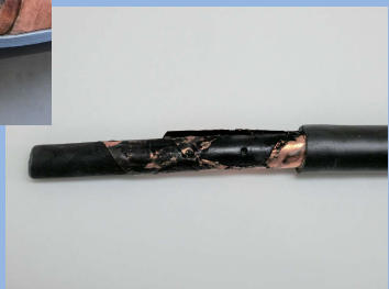
ケーブル事故写真
